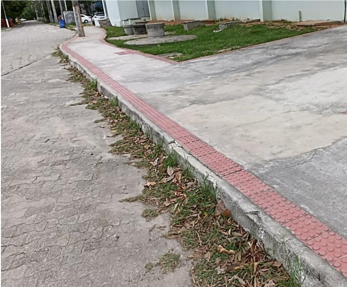
Figura 12 – Sarjeta existente. Fonte: Autor (2022)
