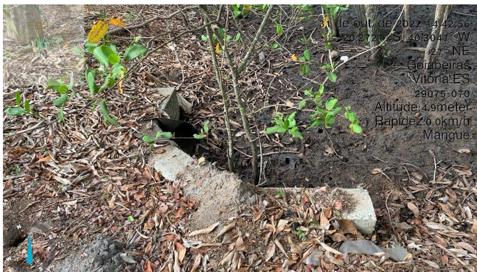
Figura 08 – Desague Final de Água Pluvial no Mangué.
