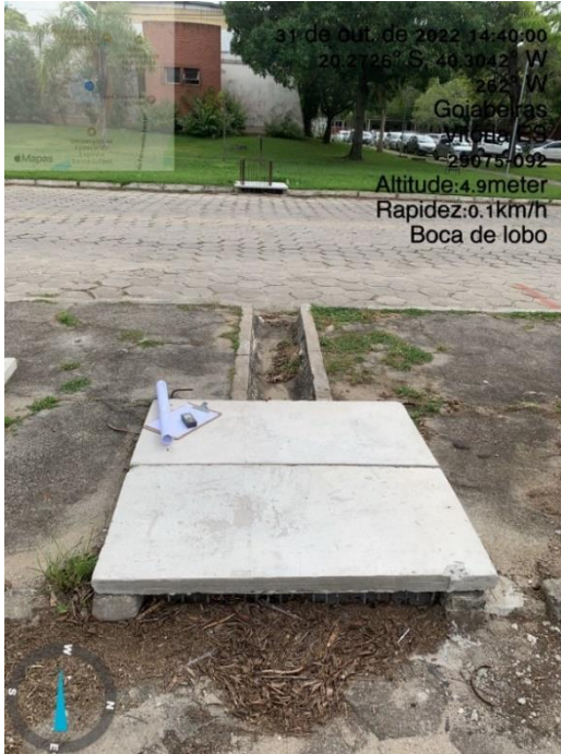
Figura 02 – Boca de Lobo Dupla Existente com calhas.
