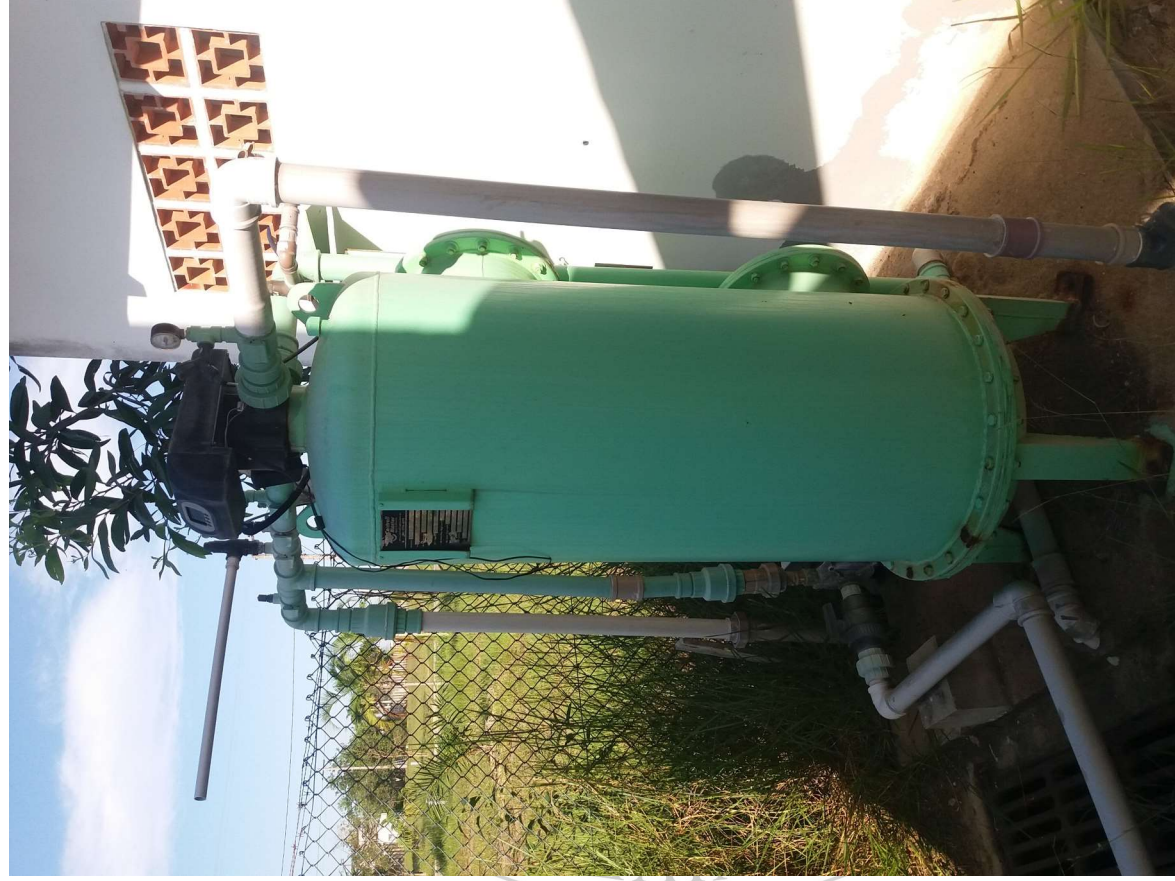
Foto 02: Verificação/substituição do elemento filtrante
