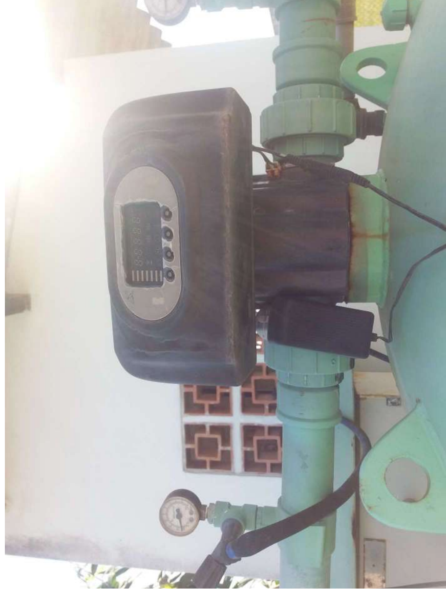
Foto 09: Verificação da funcionalidade do acionador e conexões e cabos elétricos
