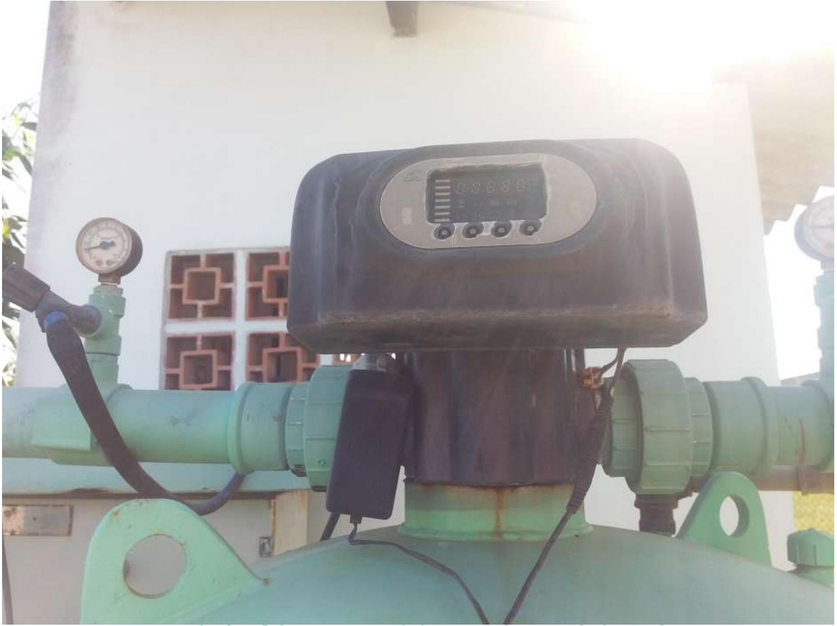
Foto 09: Verificação da funcionalidade do acionador e conexões/cabos elétricos
